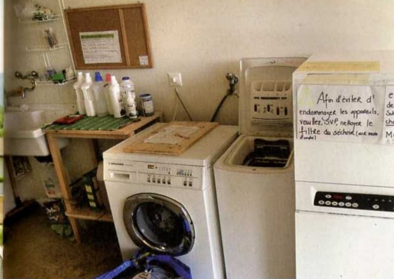
Buanderie collective de l'immeuble coopératif de Plan-les-Ouates : des économies d'équipement pour tous !
